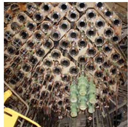
Steuerstabantriebsgehäuserohre im Inneren des Reaktors
